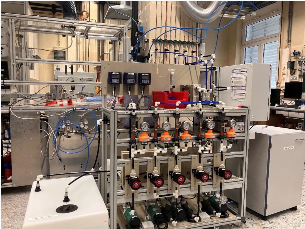
Abbildung der DOC-Anlage
